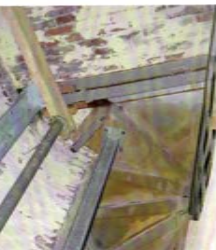
Die korrodierten Eisenträger an der Spindelstiege zum Turmzimmer – Foto: Michael Felstau
