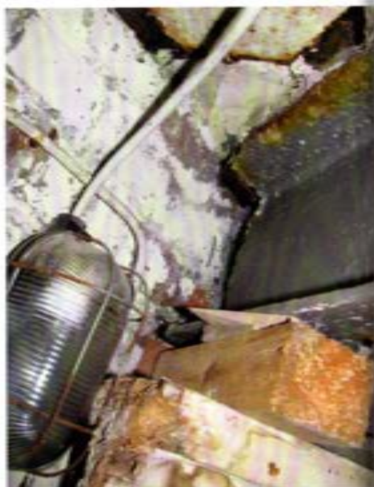
Nicht mehr tragfähige Auflager – Fotos: Michael Felstau
